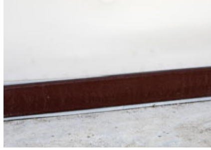
Als Ramschutz für die Abdichtung verklebt Green Protection eine elastische Leiste im Sockelbereich.
