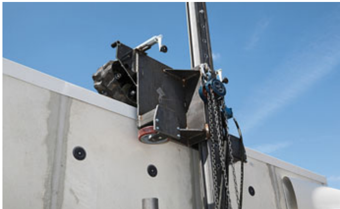
Die mobile Arbeitsbühne wird an der Mauerkrone eingehängt. Ein auf der Wand laufendes Band sorgt für die passende Bewegung.
